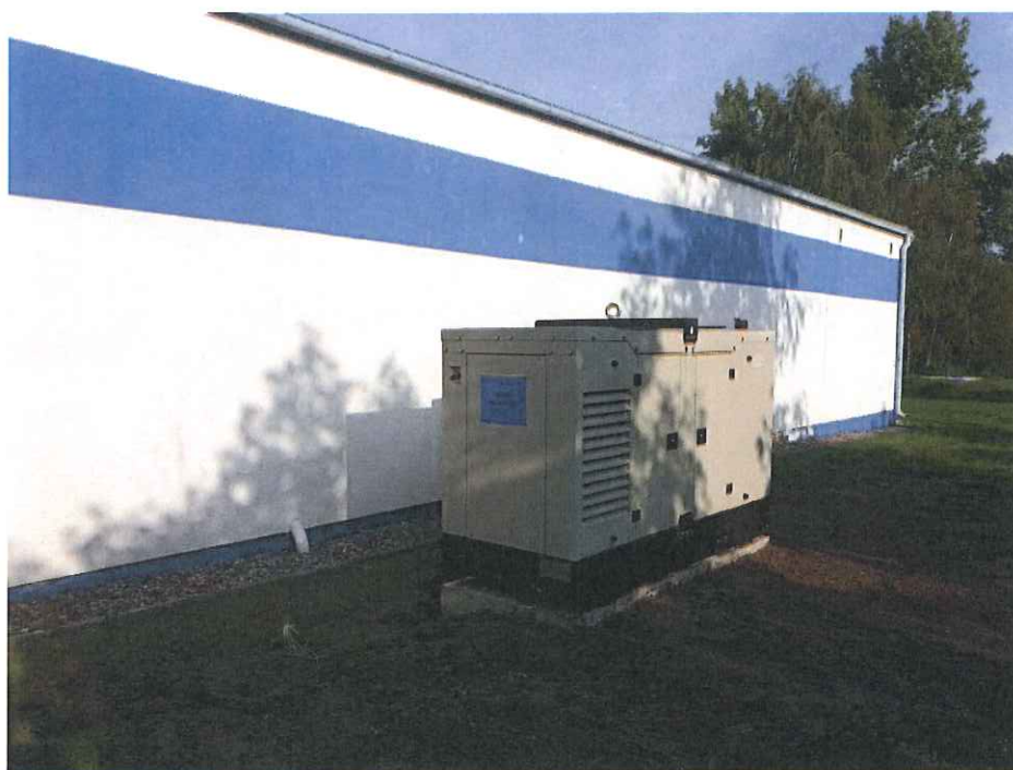
Zdj. Zewnętrzny agregat prądotwórczy na SUW Krzycko Wielkie
