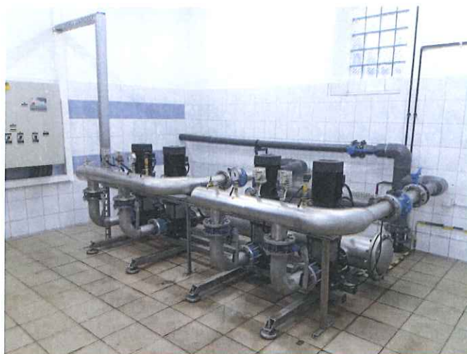
Zdj. Zmodernizowany zestaw pomp II stopnia na SUW Bukowiec Górny.
