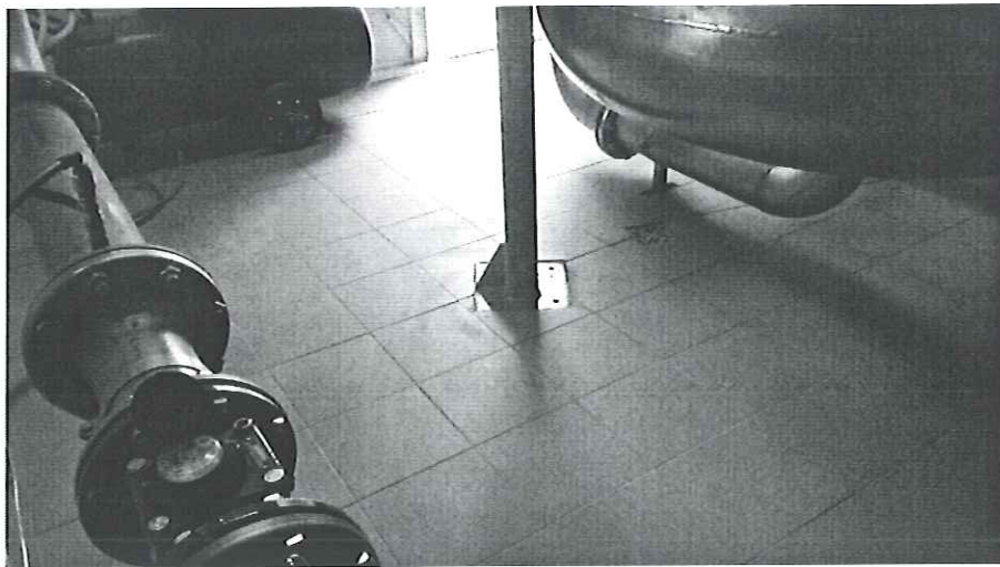
Wnętrze Kontenerowej Stacji Uzdatniania Wody
